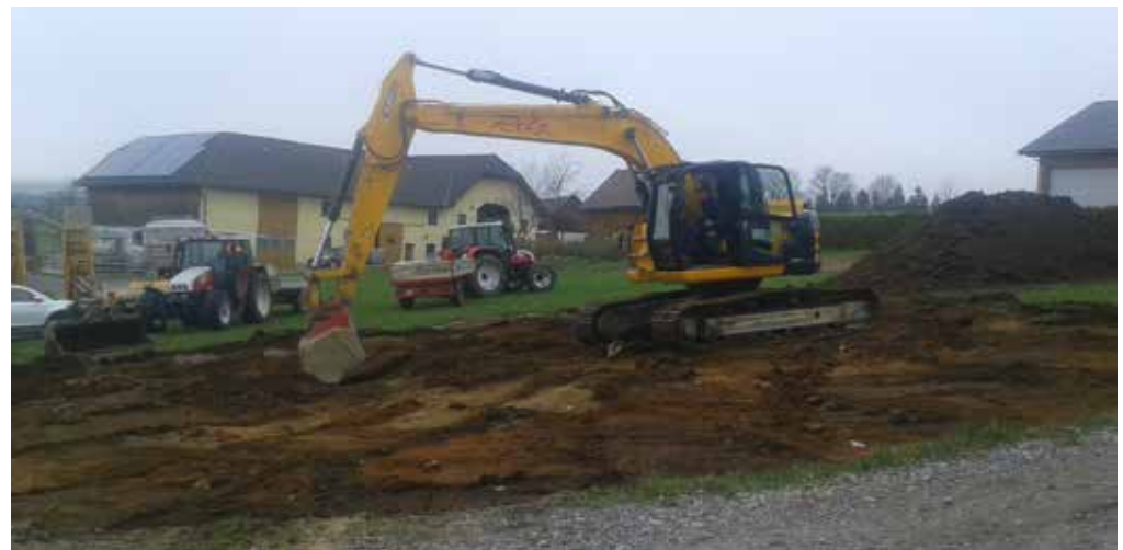
Durch starken Zusammenhalt der Nachbarn wurde der Löschwasserbehälter möglich
